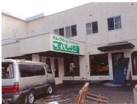
施設入口 1階室内壊滅
